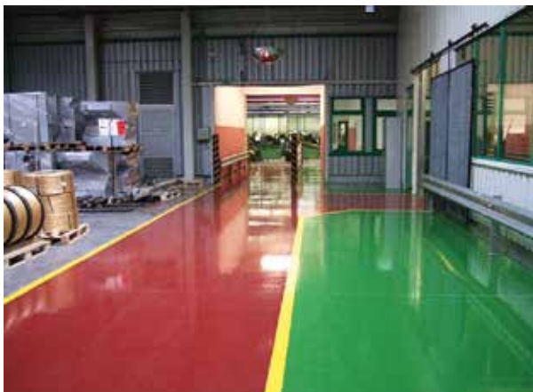
Ipari csarnok padlóbevonata Száras technológiájú helységek
